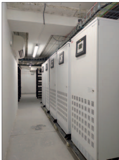
UPS moduly: 5x40 kVA
