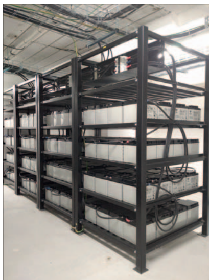
Externí bateriové pole
